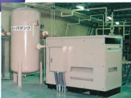
水抜きコンプレッサ・レシーバタンク
