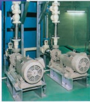
洗浄水ポンプ
