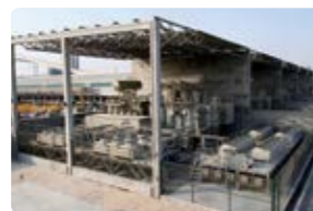
大容量整流設備
