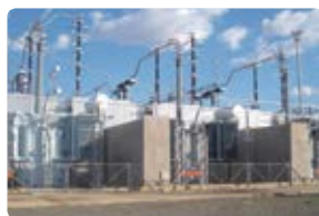
大容量変圧器
