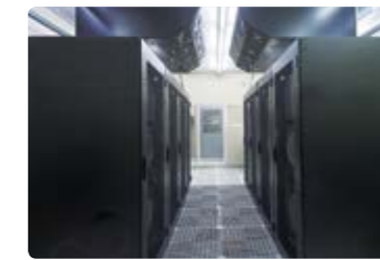
データセンター
